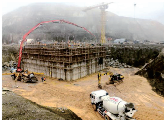
米拉多铜矿废石破碎站
